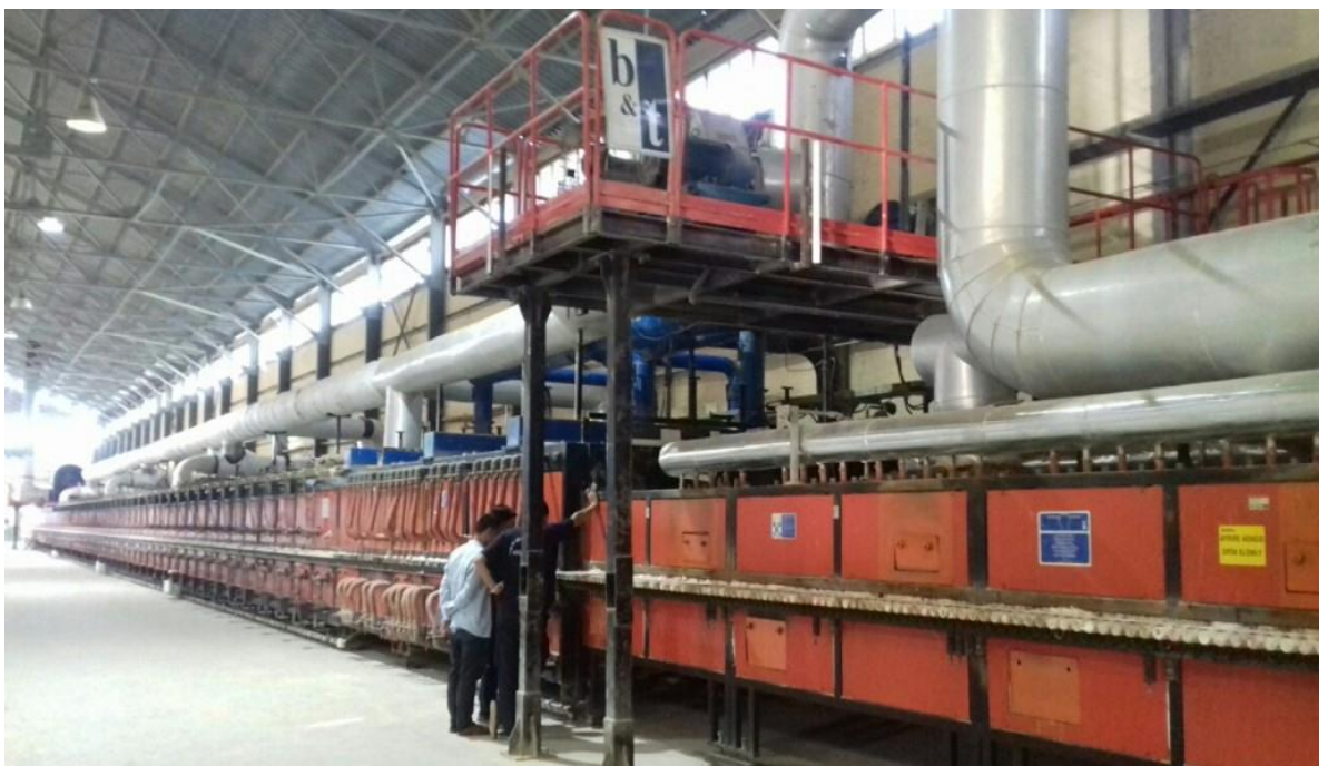
Hình 7: Hệ thống lò nung thanh lăn
